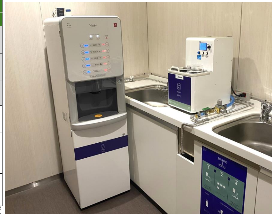
▲マイボトル洗浄機と給茶機の設置状況
